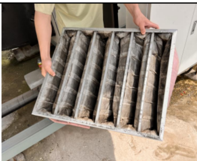
中效过滤器过滤
