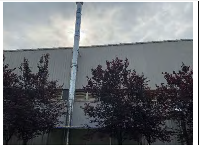
有机废气处理设施排气筒
