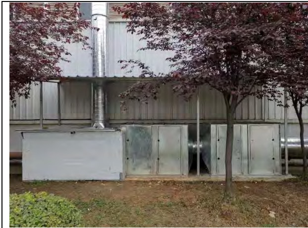
有机废气处理设施
