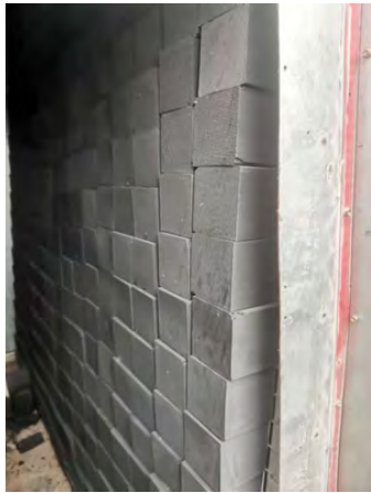
1#生产厂房面漆房废气处理设施（活性炭）（P1-2）
