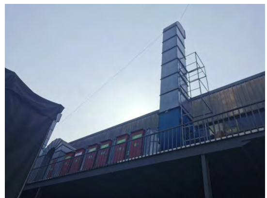
1#生产厂房底漆房排气筒 (P1-4)
