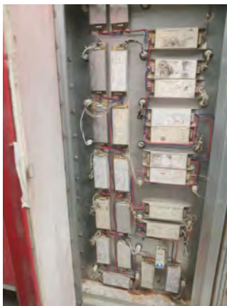
1#生产厂房面漆房废气处理设施 (UV 光氧) (P1-2)
