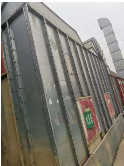
1#生产厂房底漆房废气处理设施（喷淋）（P1-3）
