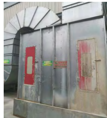
1#生产厂房面漆房废气处理设施 (喷淋) (P1-2)
