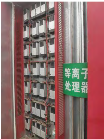
1#生产厂房底漆房废气处理设施（等离子）（P1-3）
