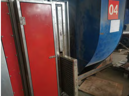
喷漆房处理设施 (活性炭) (P2-4)
