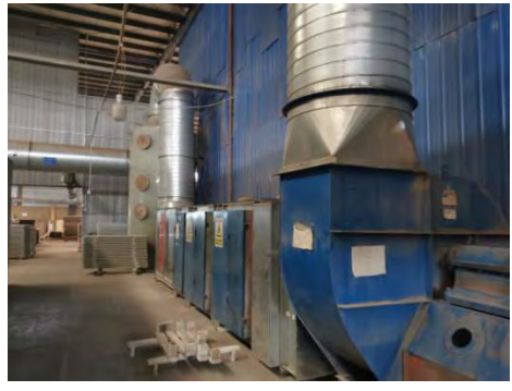
喷漆房处理设施 (P2-4)
