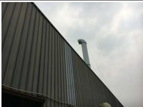
板材实木车间中央除尘器排气筒 (P2-1)
