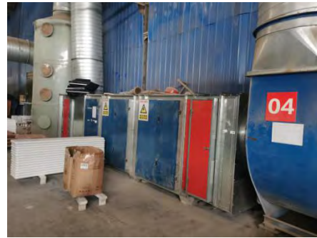
喷漆房处理设施 (P2-3)
