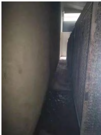
底漆打磨废气处理设施 (P2-8)
