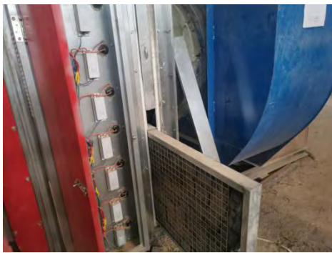
喷漆房处理设施 (活性炭) (P2-5)
