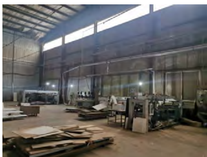
开料、钻孔、铣型设备集气管道
