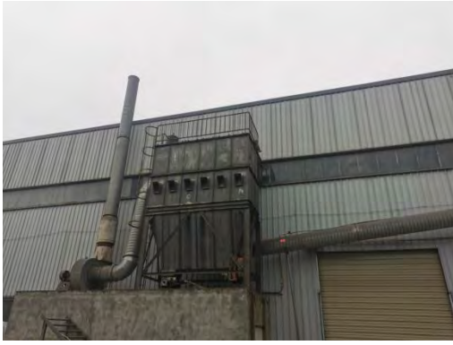
沙发、及定制车间中央除尘器排气筒 (P2-2)
