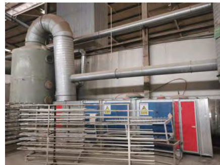
喷漆房处理设施 (P2-5)
