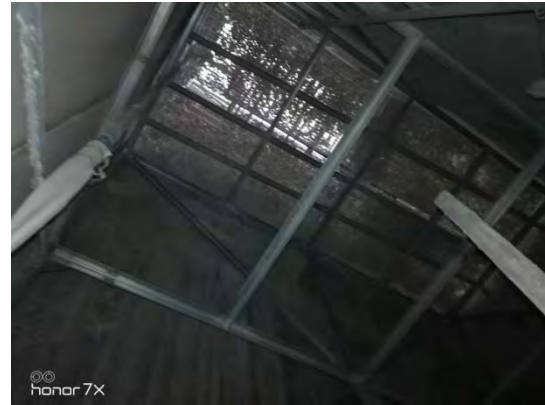
1#生产厂房内干砂房水喷淋 (P1-1)
