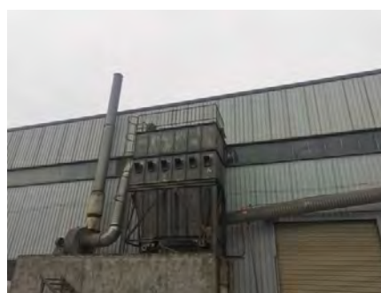
沙发车间中央除尘器排气筒 (P2-2)
