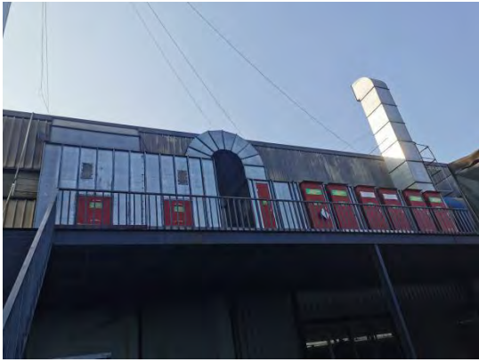
1#生产厂房底漆房排气筒 (P1-3)
