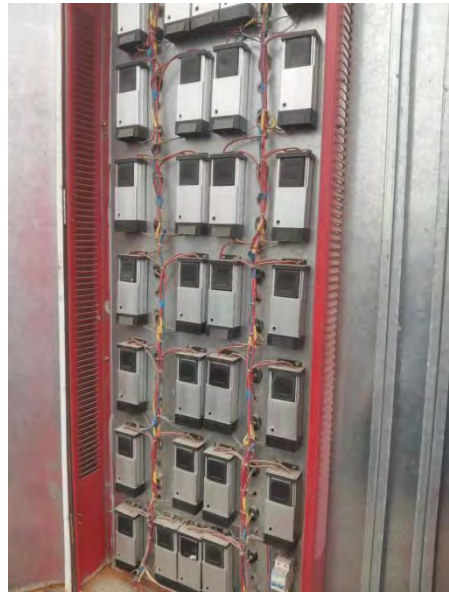
1#生产厂房底漆房废气处理设施 (等离子) (P1-4)
