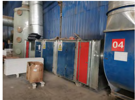
喷漆房处理设施 (P2-3)
