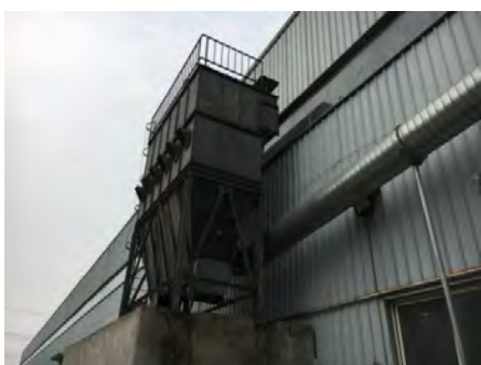
沙发车间中央除尘器 (P2-2)
