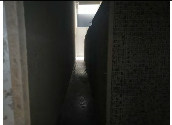
底漆打磨废气处理设施 (P2-9)
