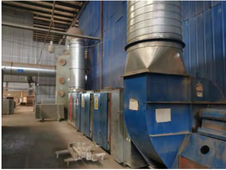
喷漆房处理设施 (P2-4)
