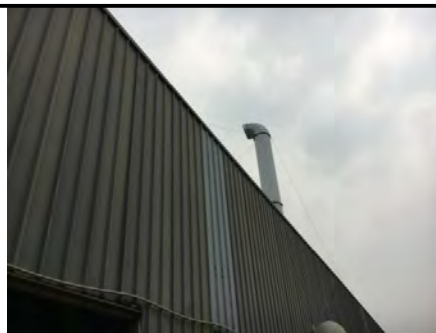
板材实木车间中央除尘器排气筒 (P2-1)
