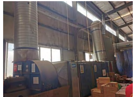
喷漆房处理设施 (P2-6)
