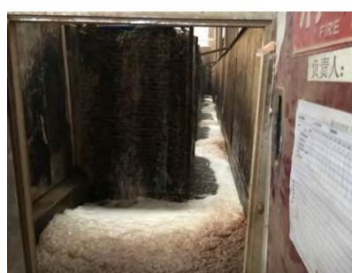
灰工打磨水幕+水洗球除尘装置
