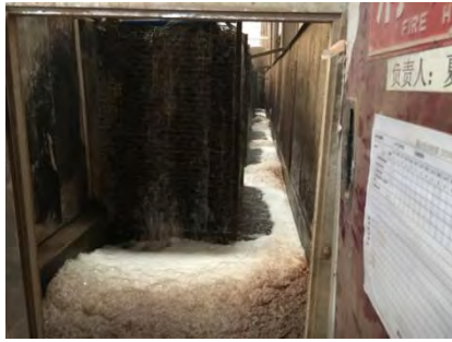
灰工打磨水幕+水洗球除尘装置
