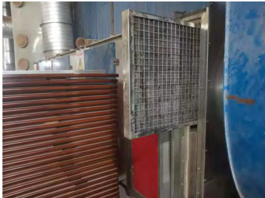
喷漆房处理设施 (活性炭) (P2-3)
