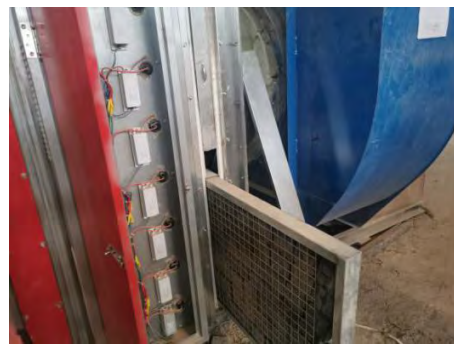
喷漆房处理设施（活性炭）（P2-5）
