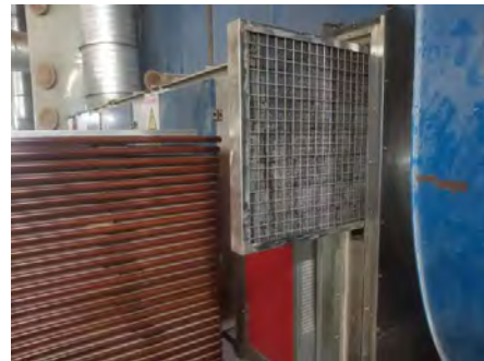
喷漆房处理设施 (活性炭) (P2-3)
