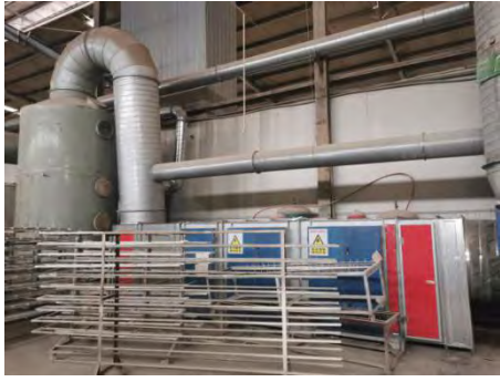
喷漆房处理设施 (P2-5)
