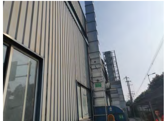
1#生产厂房面漆房排气筒（P1-2）
