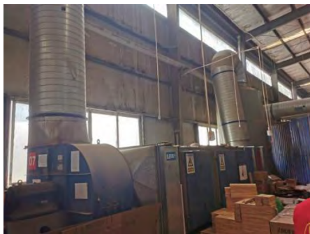
喷漆房处理设施（P2-6）
