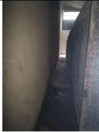
底漆打磨废气处理设施 (P2-8)
