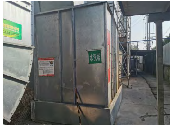
1#生产厂房底漆房废气处理设施 (喷淋) (P1-4)
