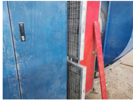
喷漆房处理设施（活性炭）（P2-6）
