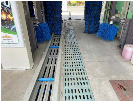
洗车机调节池
