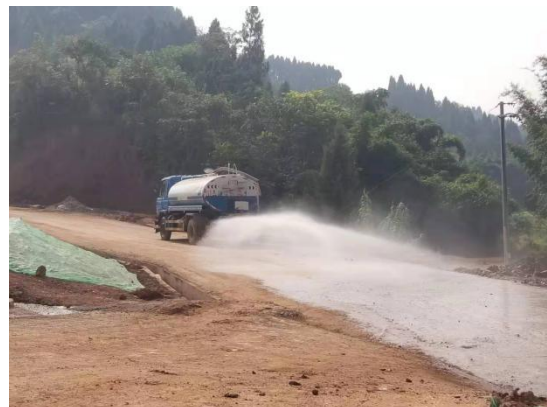
降尘措施（洒水作业）
