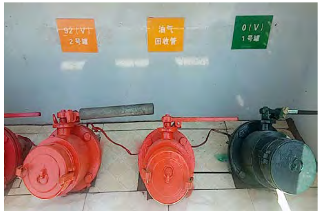
卸油油气回收
