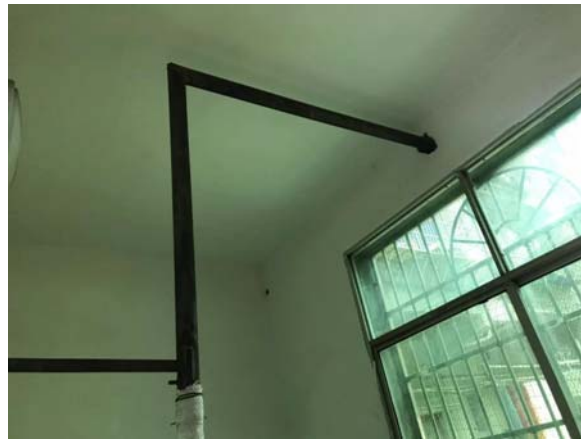
柴油发电机排气管道
