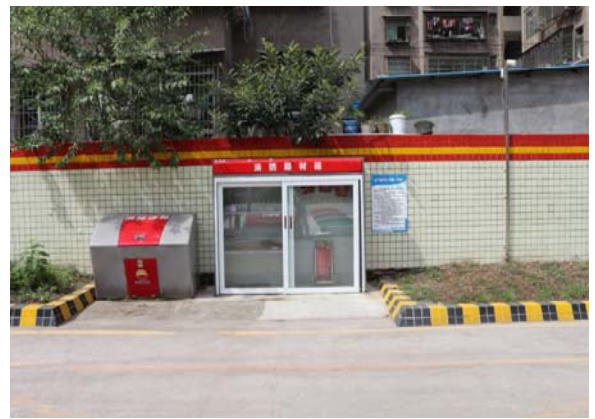
消防器材柜及消防沙箱
