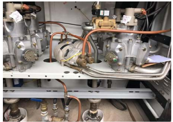
加油机二次油气回收系统
