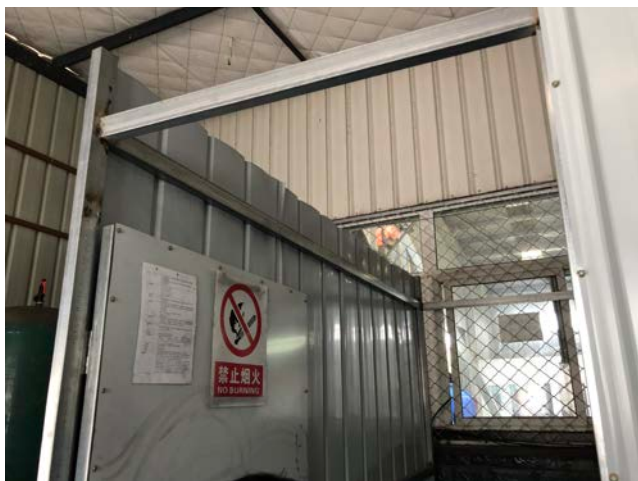
石油液化气暂存间及标识
