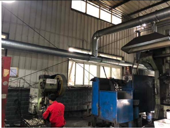
集气罩+排气管道
